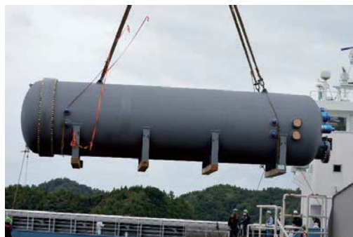
Fig. 15 Landing SOFC module (August, 2021)
