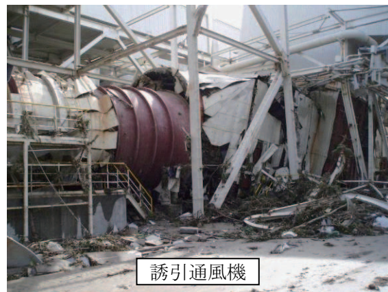
Fig. 7 原町火力発電所の被害状況
