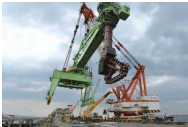
Fig.10 原町火力発電所復旧状況 (揚炭機水切り)
