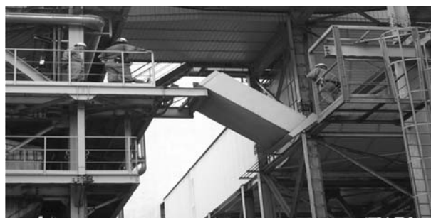
Fig. 7 損壊した制御盤
