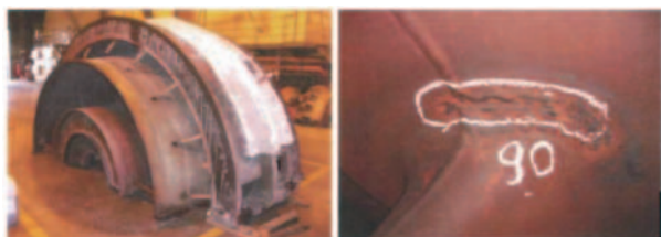
図5 長期間運用された排気車室と発生したクラック
