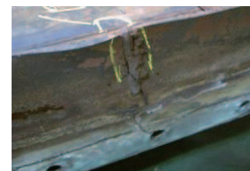
フランジボルト穴の貫通き裂
