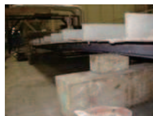
パネルの変形
